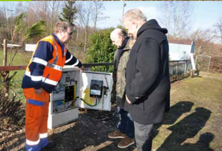
So sieht das Innenleben eines funktionsfähigen Schaltschranks aus – W. Heinrichs im Gespräch mit Gästen
